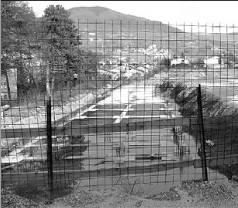
Opuščeno gradbišče na območju Ronket
