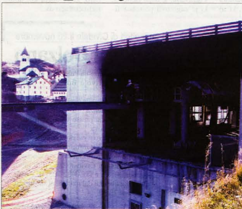
Od požara uničena zgornja postaja žičnice na Višarjah
