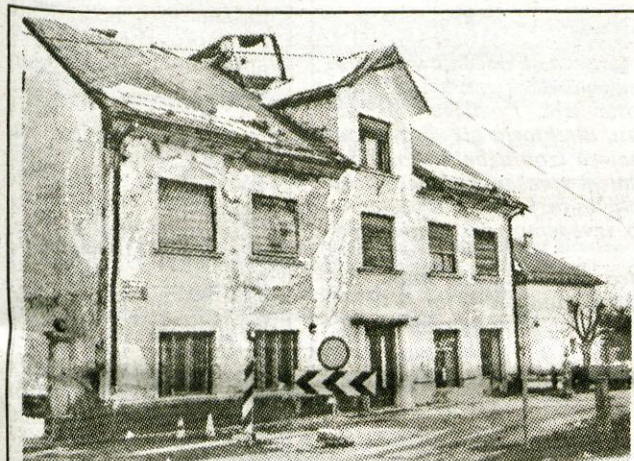
Duplje, 15. aprila - Prometna inšpekcija je zahtevala uvedbo delne zapore za promet ob hiši v Spodnjih Dupljah 1 zaradi nevarnosti za zrušitev ostanka bunkerja s strehe. Kot je sedaj ugotovila gradbena inšpekcija, se omenjeni objekt nagiba na drugo stran, zato ni verjetno, da bi ostanki padli na cesto. V občini Naklo čakajo na izdajo odločbe omenjene inšpekcije, takoj zatem pa bodo zaporo na cesti odstranili. Vsi zapleti so nastali zaradi propadajoče hiše, ki so jo že vrnilo nekdanjem lastnikom, vendar le-ti terjajo tudi odškodnino, s katero bi stavbo obnovili. • S. Saje
