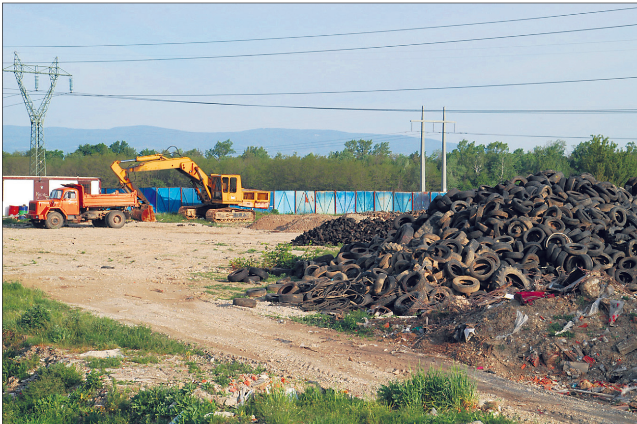
Gramoznica v Lovrencu, kjer v teh dneh že potekajo prva sanacijska dela, je le eno od dvajsetih večjih divjih odlagališč na območju občine Kidričevo.
