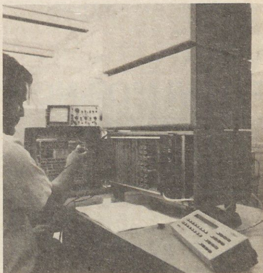
Moderna naročniška, elektronska telefonska centrala sistema SI 2000/014 za 248 priključnih točk. Zasnovana je modularno in ima mikroročunalniško krmiljenje. Konstruirali in izdelali so jo v Iskri, industriji za telekomunikacije v Kranju
