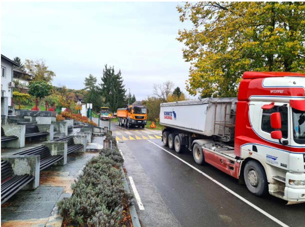
Narejena je tudi nova plast asfalta na državni cesti Zavrč–Drenovec, v naselju Goričak.
