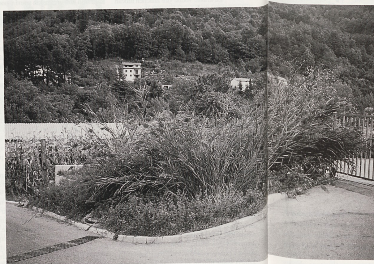
Pogled na rastlinsko čistilno napravo za čiščenje odpadnih voda podjetja Mercator - Sadje-zelenjava v Kanalu ob Soči.
