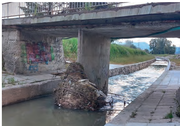
Vzdrževanje kanala Pšata med Topolami in Srednjimi Jaršami je izrednega pomena.
