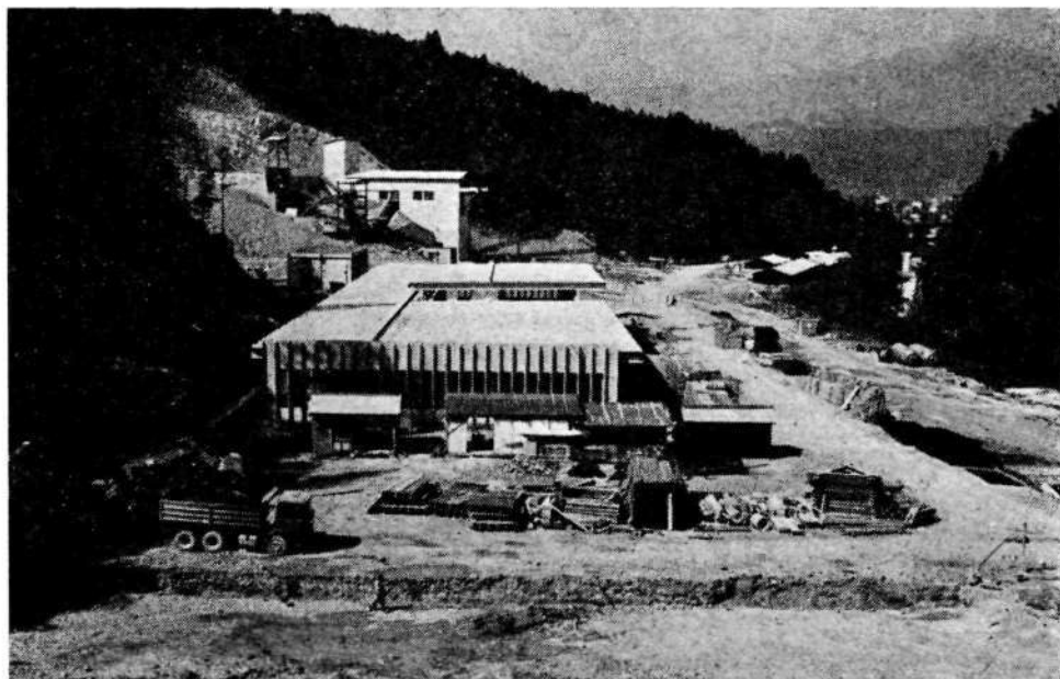
Slika 8. V letu 1983 je Gradis Jesenice, ki gradi vse zunanje objekte, začel z gradnjo delavnic, obrata jame (na sredi). Levo zadaj je vzorčevalna postaja in drobilnica rude, v katero teče transportni trak preko Brebovnice in ceste Gorenja vas—Lučine v predelovalni obrat. V ozadju nad Gorenjo vasjo Blegoš. Primerjaj s sliko 3. Danes stoji v izkopu v ospredju slike stavba tehničnih služb rudnika. (Foto T. Lunder)
