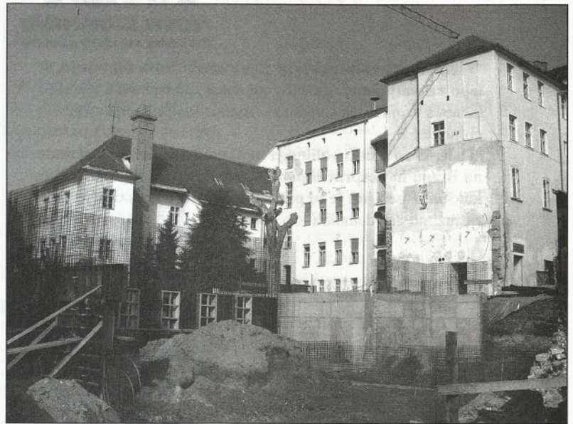
Zdaj poteka gradnja telovadnice; druga faza gradbenih del na OŠ Olge Meglič.
