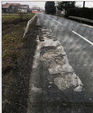
Krpanje razpok in luknj in prinaša trajne rešitve. Celovite sanacije se bo morala lotiti direkcija za ceste.
