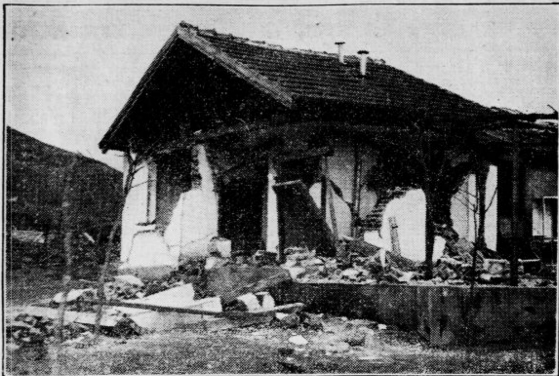
Nova hiša v Valandovu, kateri je potres na čuden način pustil streho in en sam zid
