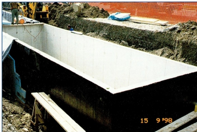
Betonski bazen, v katerem je nameščen dvoplaščni rezervoar
